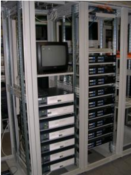
Un rack de servidores
